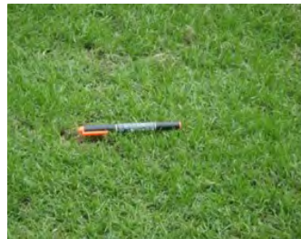
写真2. 近景 小さな剥離部分
